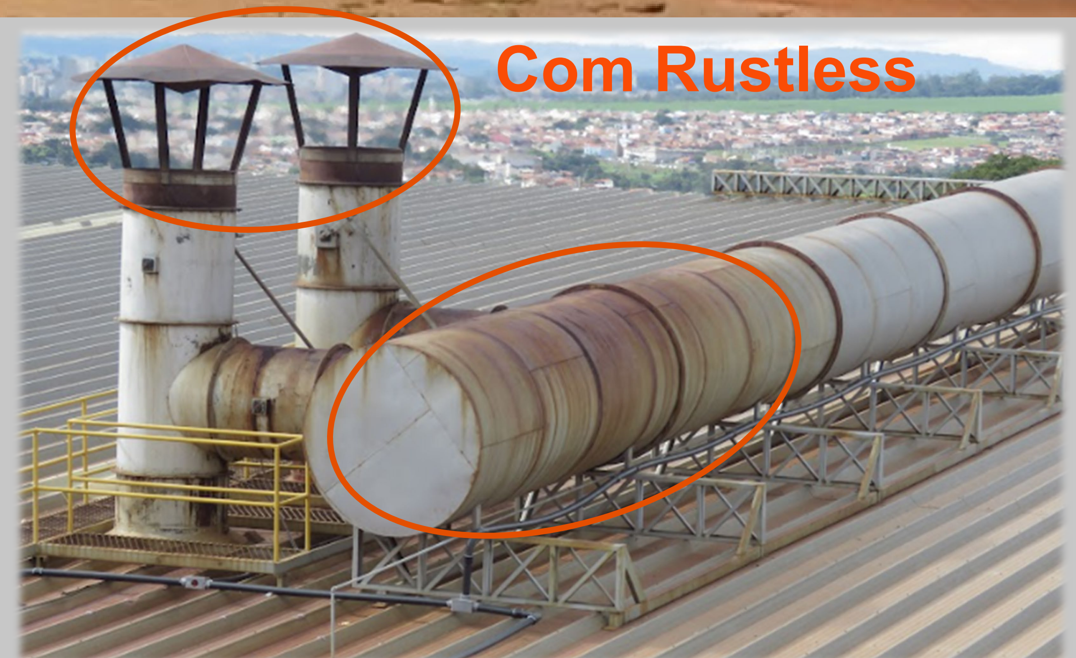
Condição da estrutura após os efeitos da tecnologia anticorrosiva Rustless.
